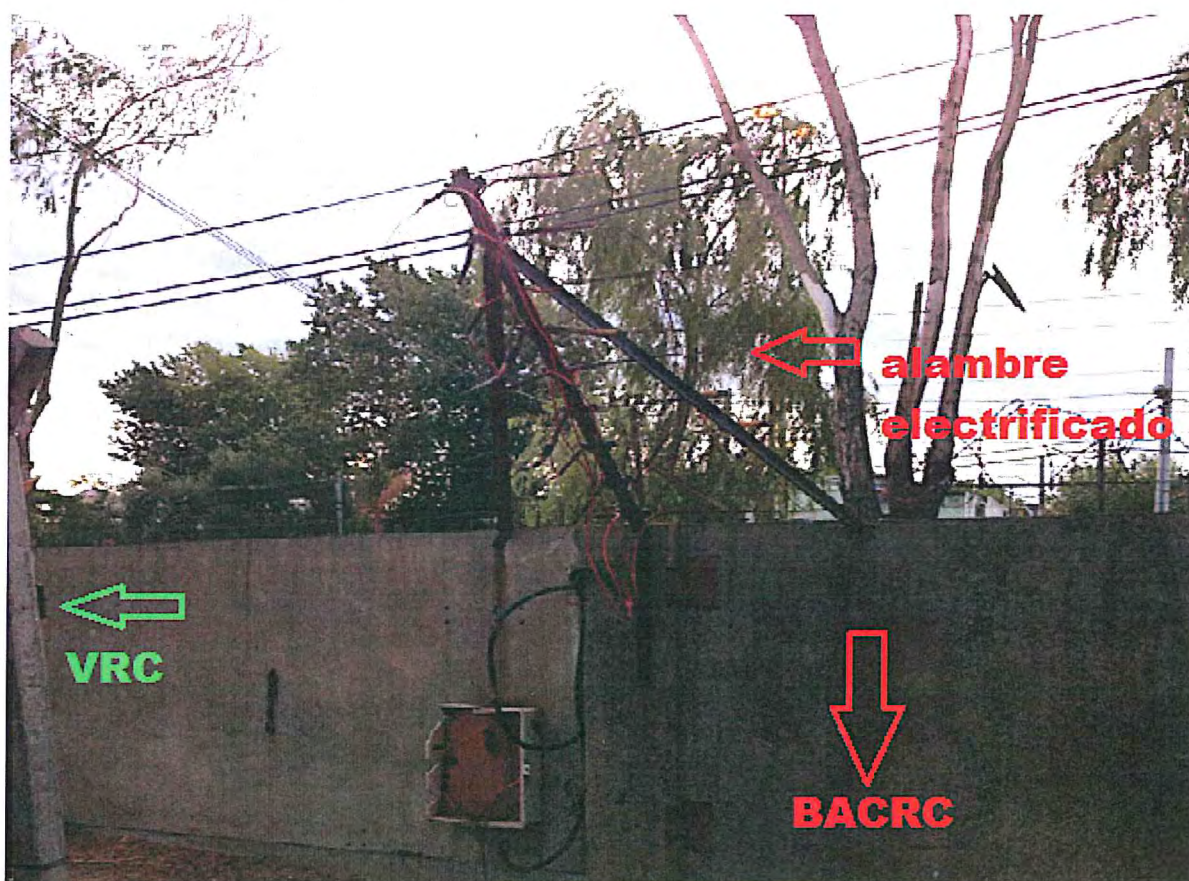
Imagen 17: muro del club BACRC con alambre electrificado.
